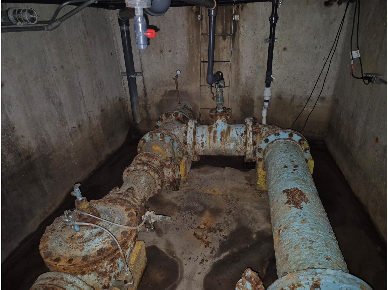
3900 S 900 E Vault
