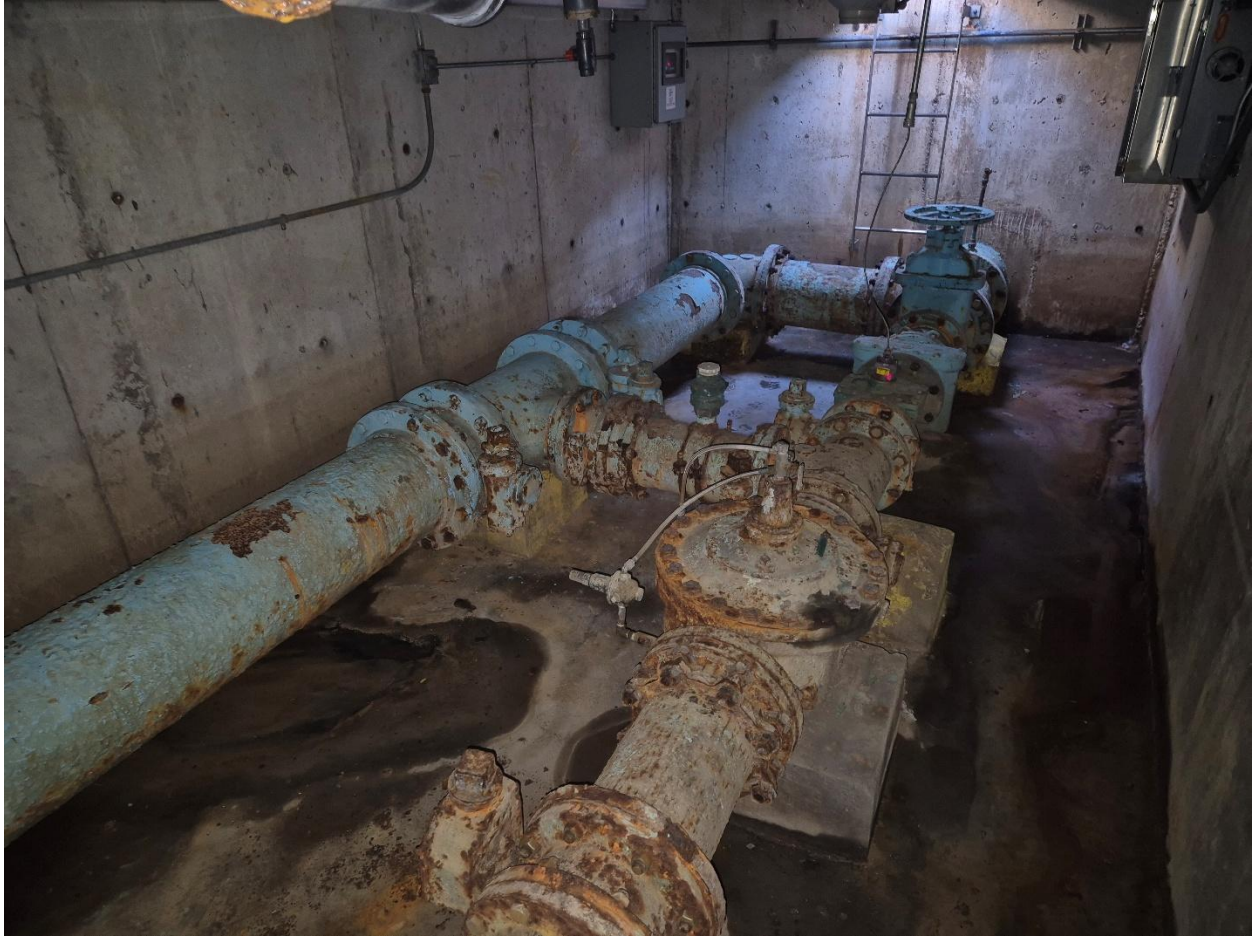
3900 S 900 E Vault
