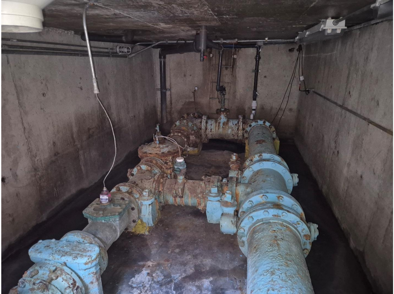
3900 S 900 E Vault
